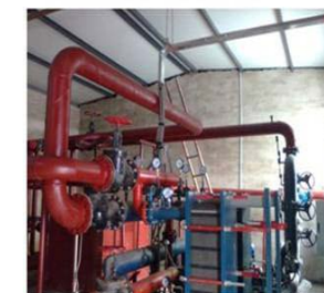
系统现场照片
