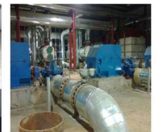
系统现场照片
